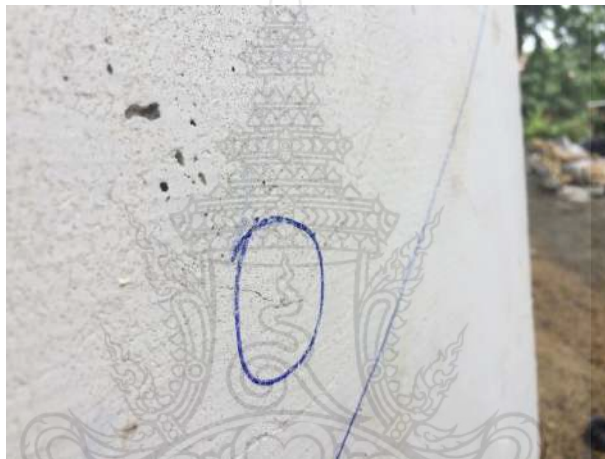
รูปที่ 16 ผนังคอนกรีตสำเร็จรูปที่ถูกวัสดุนุ่มขนาดใหญ่กระแทกจนเกิดรอยร้าว
