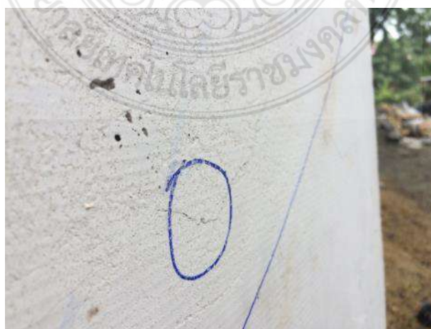
รูปที่ 4.8 ผนังคอนกรีตสำเร็จรูปที่ถูกระแทกด้วยวัสดุุ่นขนาดใหญ่กระแทกจนเกิดรอยร้าว
