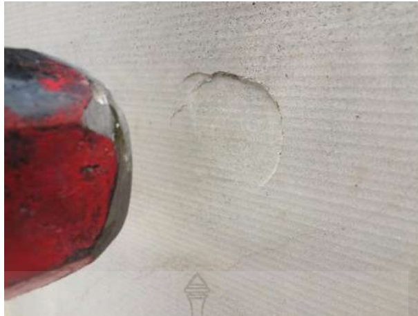
รูปที่ 15 ผนังคอนกรีตสำเร็จรูปที่ถูกวัสดุแข็งขนาดเล็กกระแทกจนเกิดรอยยุบ
