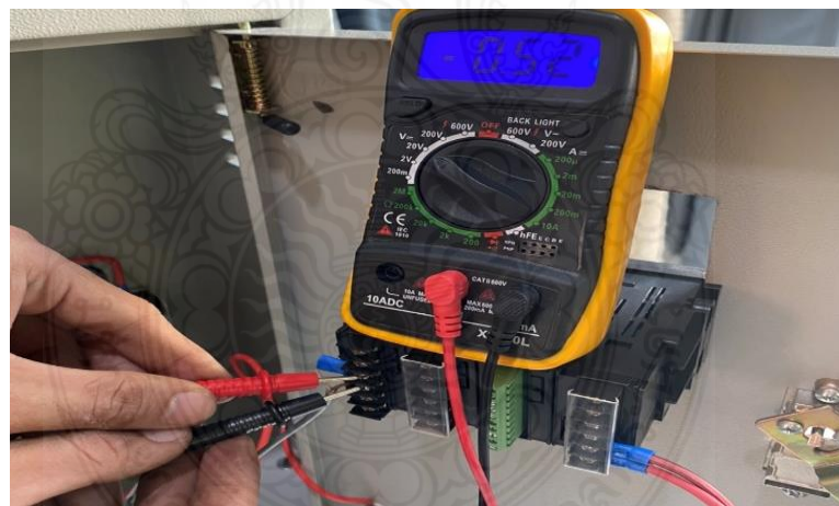
ภาพที่ 3.19 การวัดกระแสไฟโดยใช้มัลติมิเตอร์
