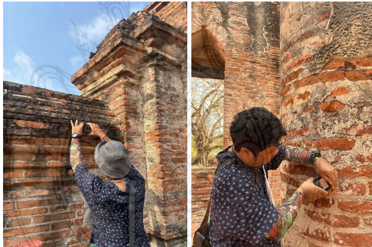
ภาพที่ 143 ใช้เครื่องมือวัดค่าสีบริเวณศาสนสถาน ที่มา: สุนทร บินกาซานิ (2567)
