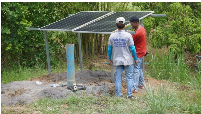
ภาพที่ ก.5 การติดตั้งแผงเซลล์แสงอาทิตย์ ณ ตำบลตาหลังใน อำเภอวังน้ำเย็น จังหวัดสระแก้ว
