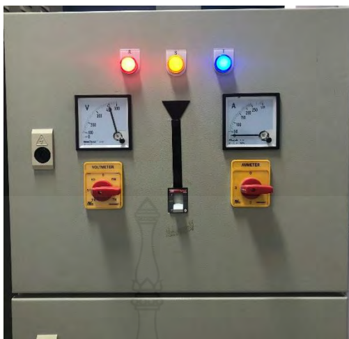
รูปที่ 3.7 กล่องควบคุมแรงดันไฟฟ้าของมอเตอร์ไฟฟ้า
