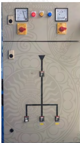
รูปที่ 3.6 กล่องควบคุมแรงดันไฟฟ้าหลักของเครื่องทดสอบ
