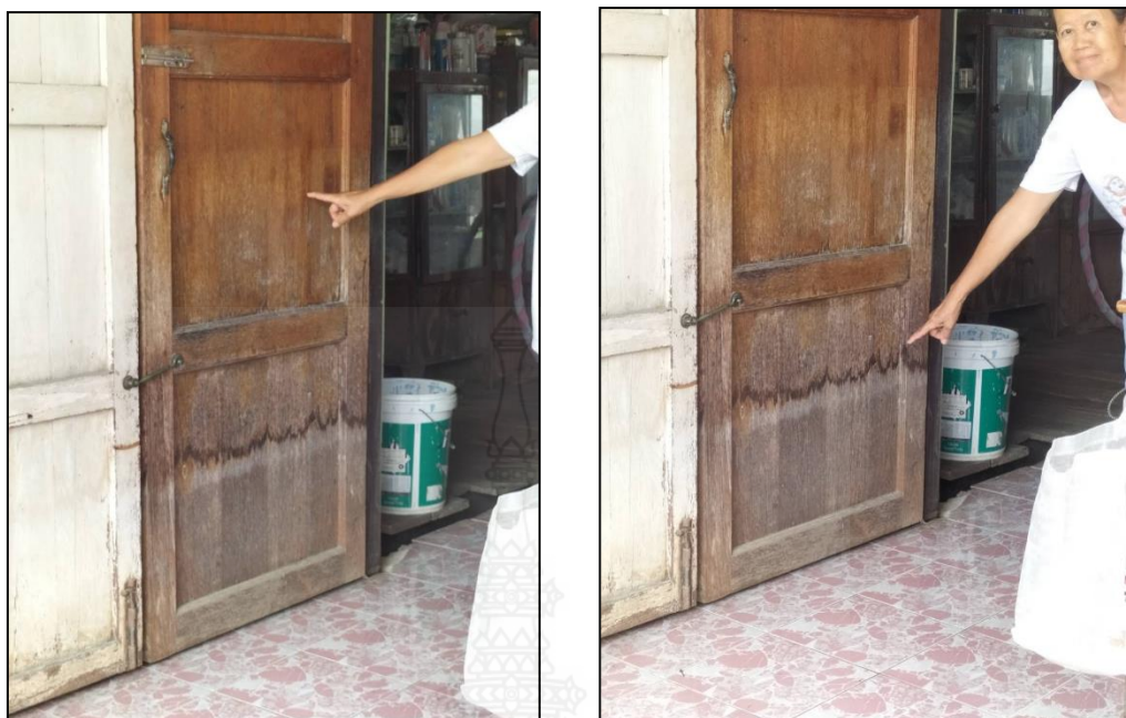
ภาพที่ 4.4 ระดับน้ำท่วมในบ้านของชาวบ้านรายหนึ่งตามแนวน้ำขึ้นในปี พ.ศ. 2554 (ภาพซ้าย) และ พ.ศ. 2564 (ภาพขวา)
