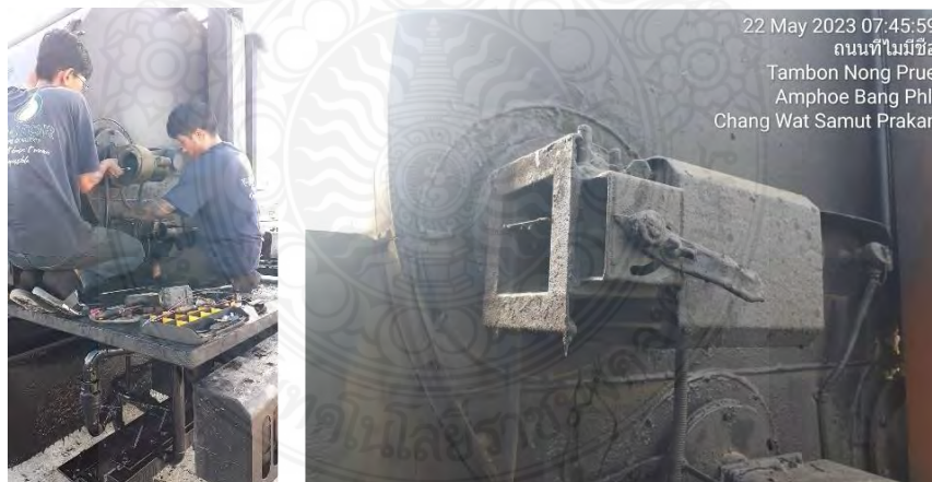
รูปที่ 3.6 เครื่องอัดอากาศ
