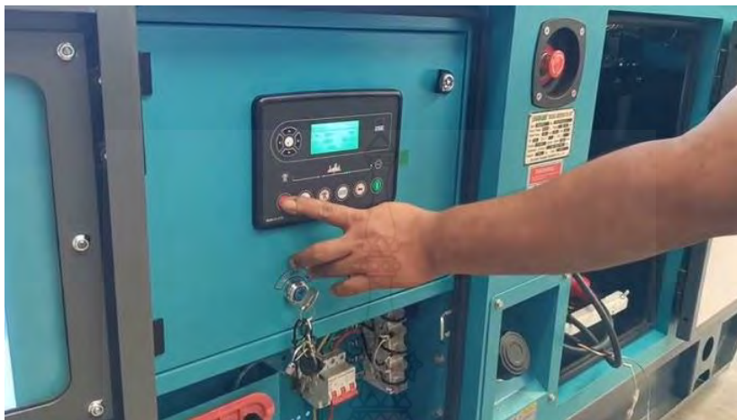
รูปที่ 2.9 เครื่องกำเนิดไฟฟ้า
