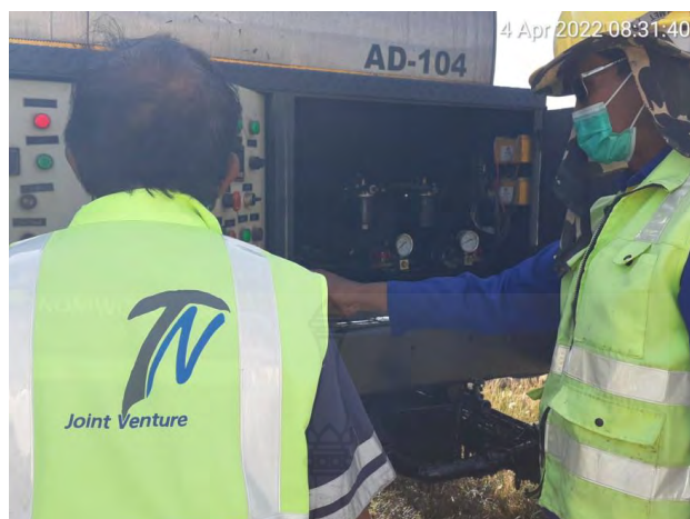
รูปที่ ก.1 ตรวจสอบตู้ควบคุมการทำงานของเตาเผา
