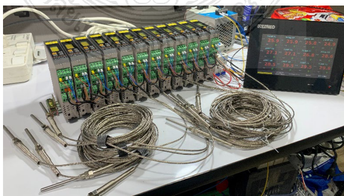
รูปที่ 3.8 Sommy GTF2-IM28 Temp Controller และ PT100
