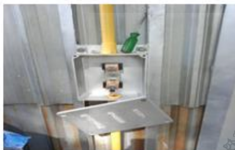
ภาพที่ 9 จานทดสอบ Ground Test Box
