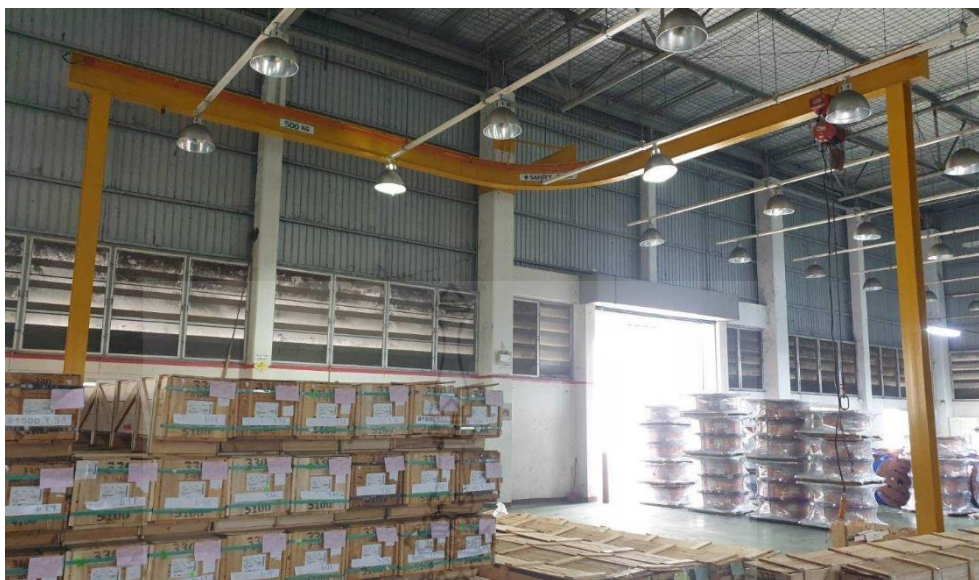
ภาพที่ 2-4 เครนโรงงานรางเลื่อนแบบไฟฟ้าคานเดี่ยว (Monorail Crane)
