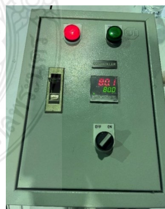
รูปที่ 3.7 ตู้ควบคุมการทำงาน Heater
